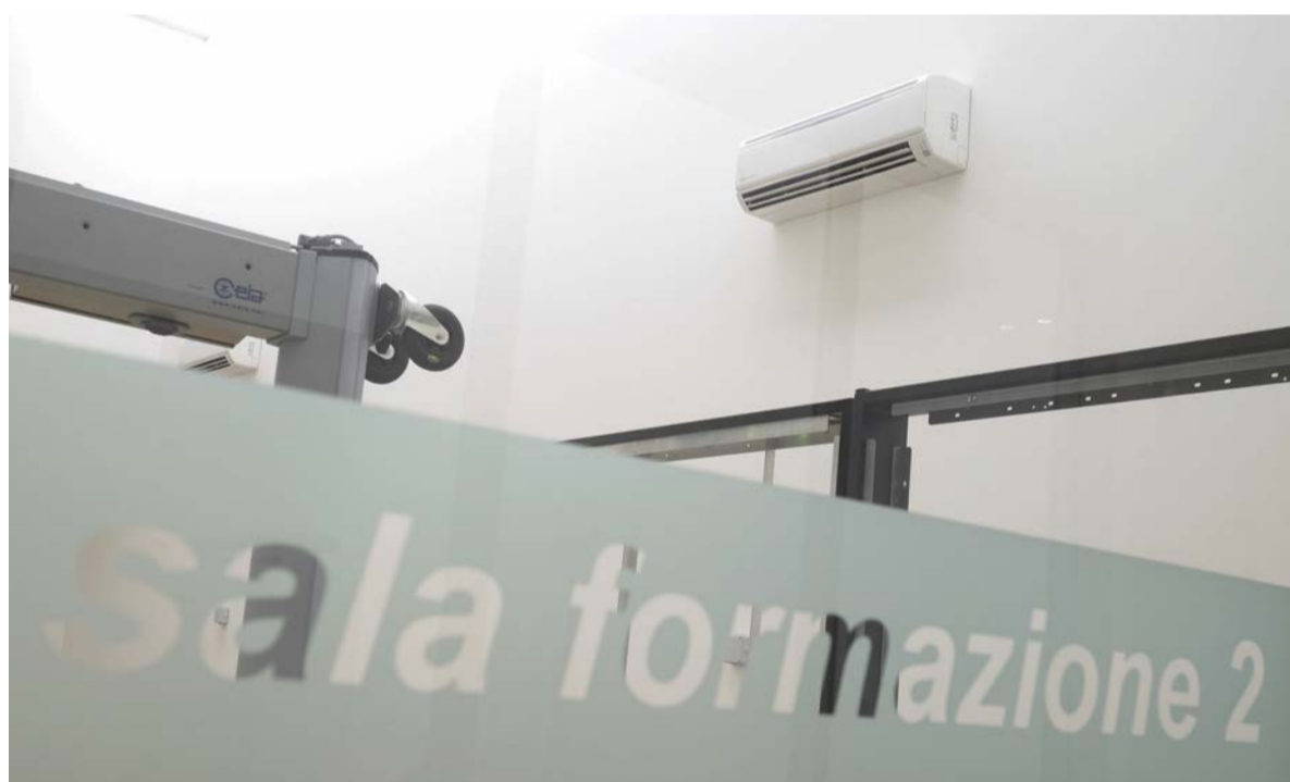
LE UNITÀ INTERNE di tipo parete o murale a servizio di una delle sale formazione.
